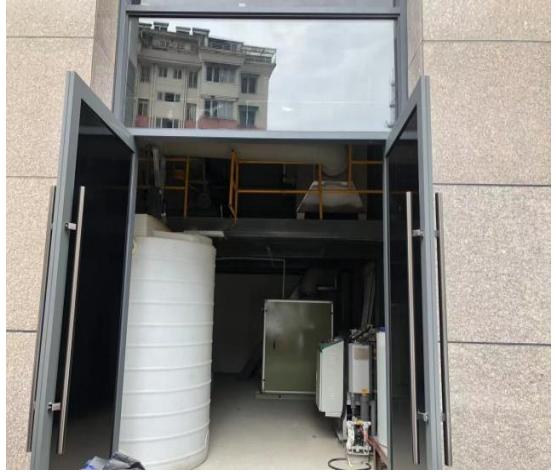
院区污水处理站
