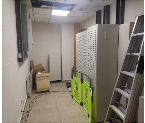
设备间 (DSA 机房南侧)
