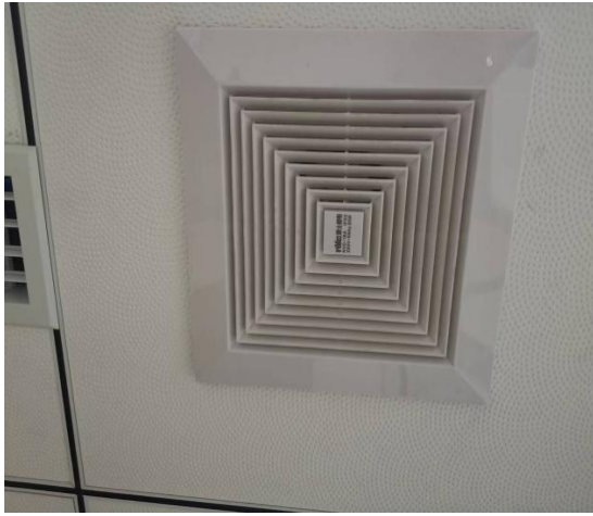
机房通风装置（排风）
