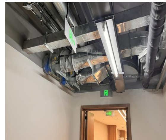
轴流风机、管道
