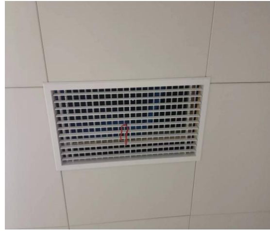
机房通风装置（进风）
