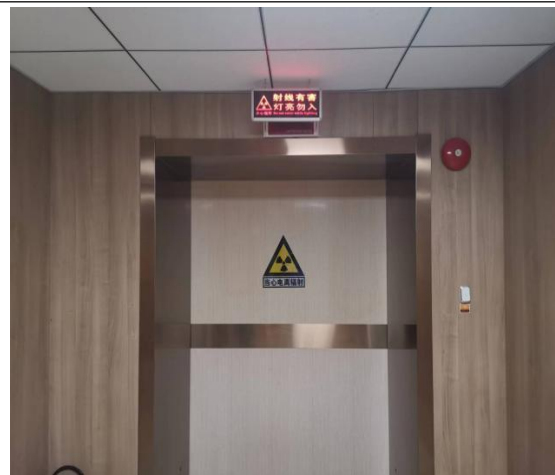
机房病人防护门（闭合）
